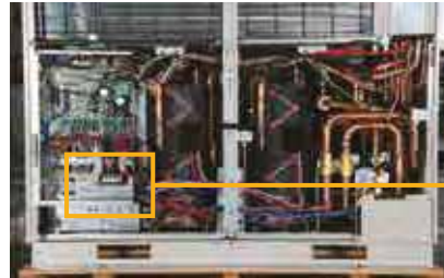
Elektrik aksam bölümü
